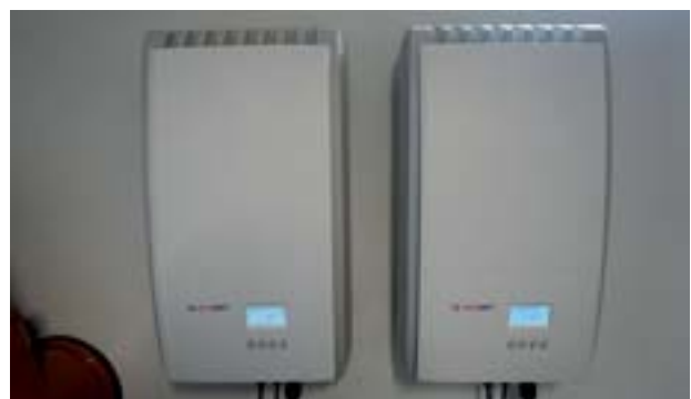
Abb. 182 Wechselrichter der Photovoltaikanlage © SAENA
