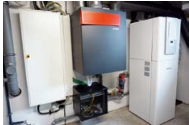
Abb. 179 Heizraum mit Wärmepumpe und Lüftungsgerät mit Wärmerückgewinnung © SAENA
