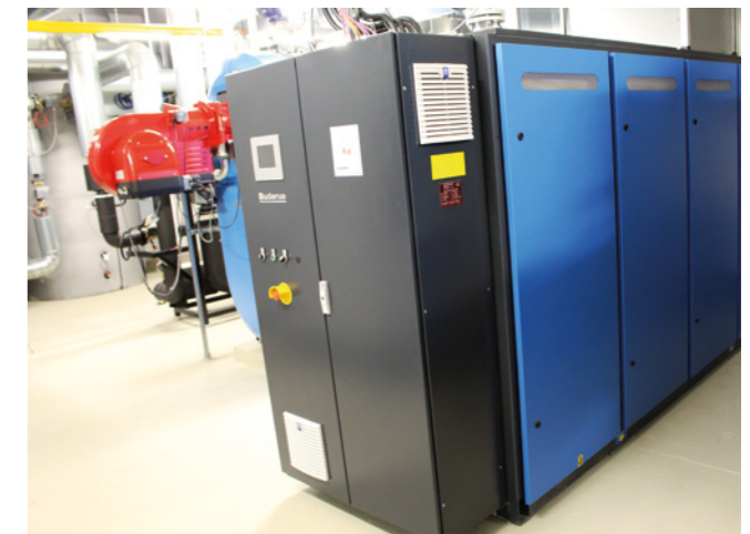
Elektrociepłownia w lokalnym centrum energetycznym nr 2 / BHKW des EEQ2
