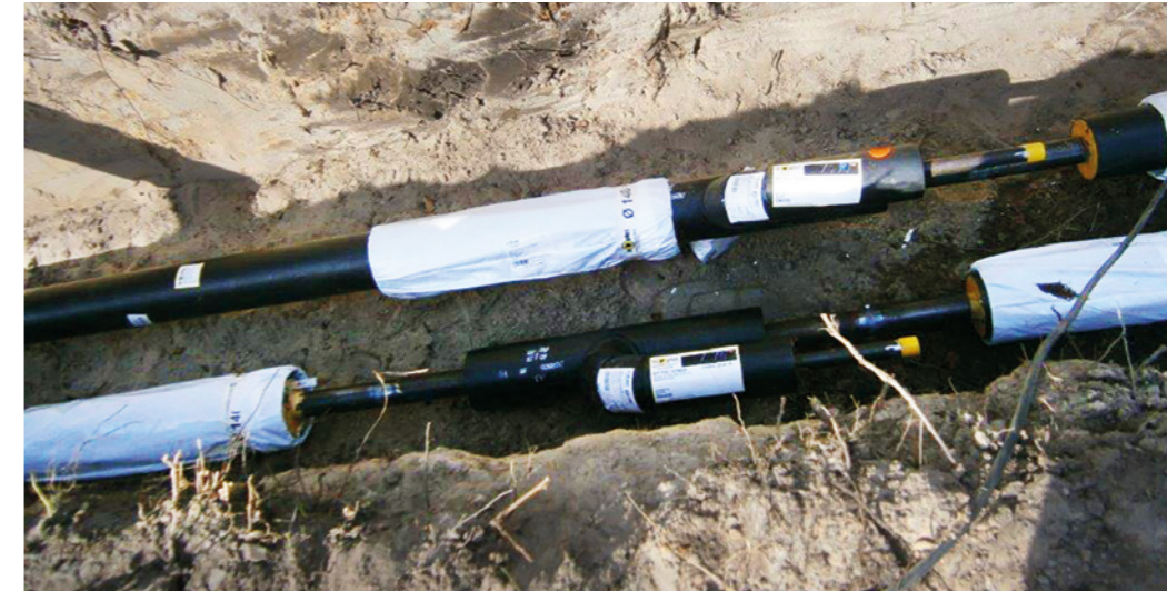
Lokalna linia ciepłownicza / Leitung des Nahwärmenetzes
