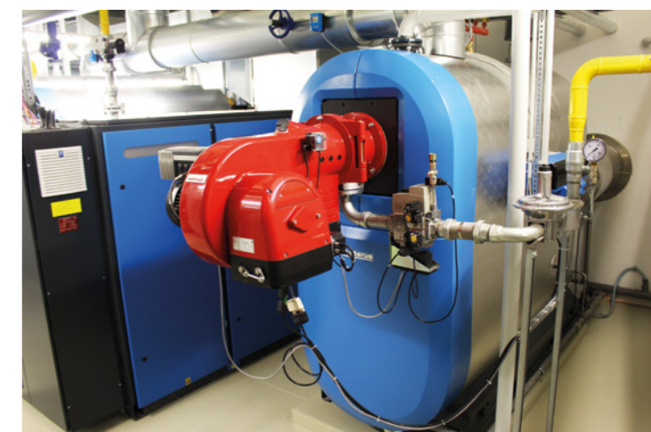
Kocioł na gaz ziemny z palnikiem gazowym / Erdgaskessel mit Erdgasbrenner
