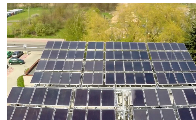
Panele solarne na dachu szpitala / Solarmodule auf dem Dach des Krankenhauses
