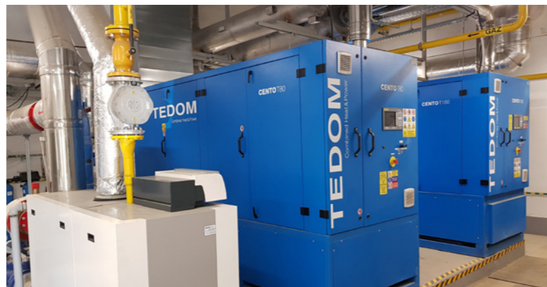
Agregaty kogeneracyjne zasilane gazem ziemnym / Erdgas-geführte Kraft-Wärme-Kopplungsanlagen
