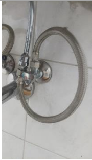
Bild 1: Eckventile unter einem Waschbecken.
