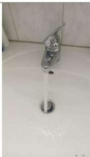
Bild 3: Auf kalt gestellter Wahlhebel. Durchflussmenge vor der Einregulierung
