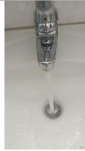
Bild 6: Trotz der Einregulierung an den Eckventilen ergibt sich in der oft benutzten Mischstellung nach wie vor ein satter Wasserstrahl.
